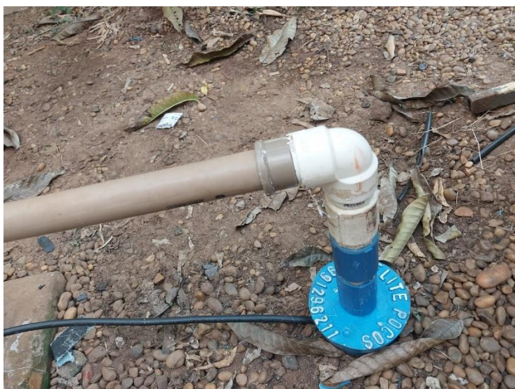
FOTO 59: Poço semiartesiano de 0.5 HP
