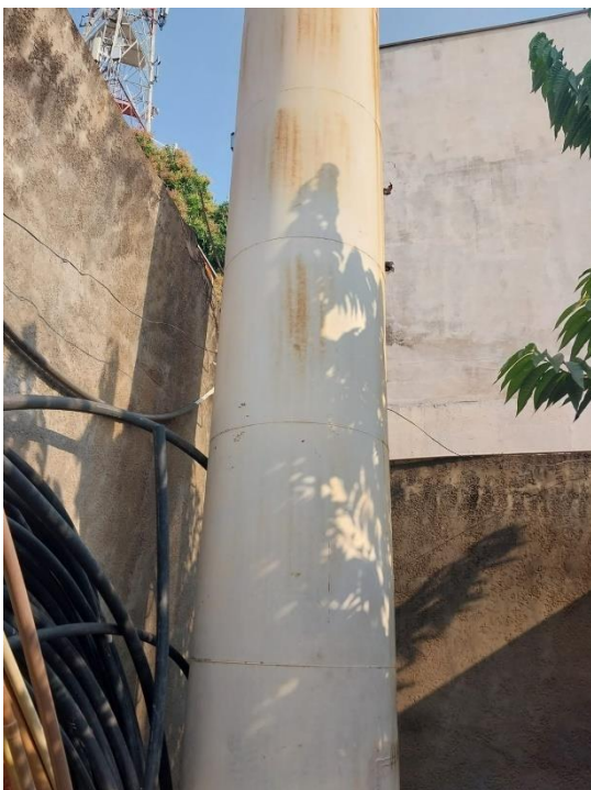
FOTO 61: Caixa d'agua metálica 9.000L
