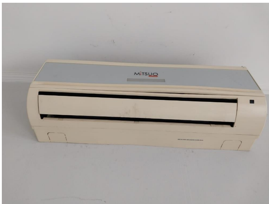
FOTO 2: Ar condicionado split 12.000 BTU Mitsuo com condensador.
