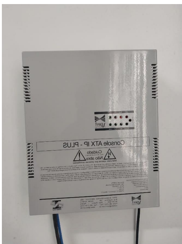
FOTO 33: Concentrador de automação das bombas de combustíveis.
