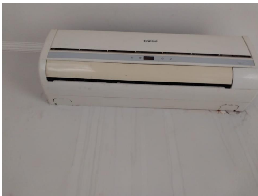
FOTO 11: Ar condicionado Consul 12.000BTU.
