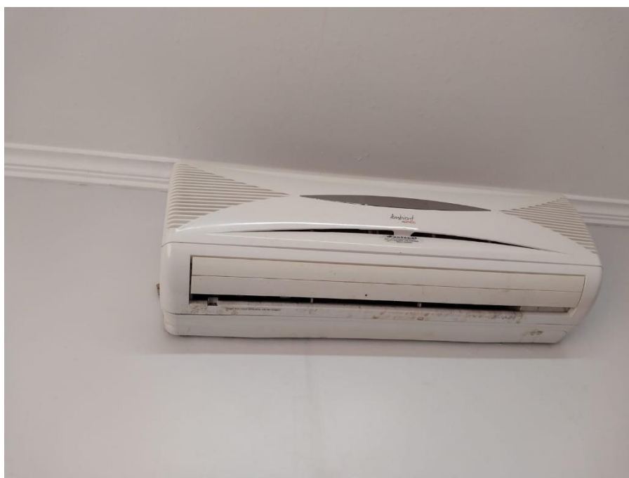
FOTO 39: Ar condicionado 12.000 BTU Split Komeco.
