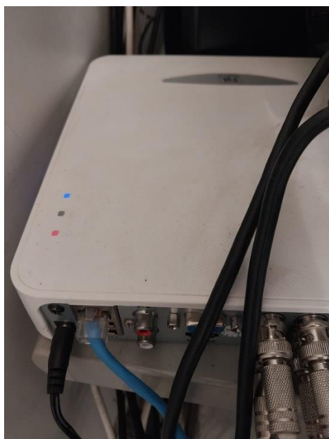
FOTO 40: Gravador DVR JFL 16 cameras.
