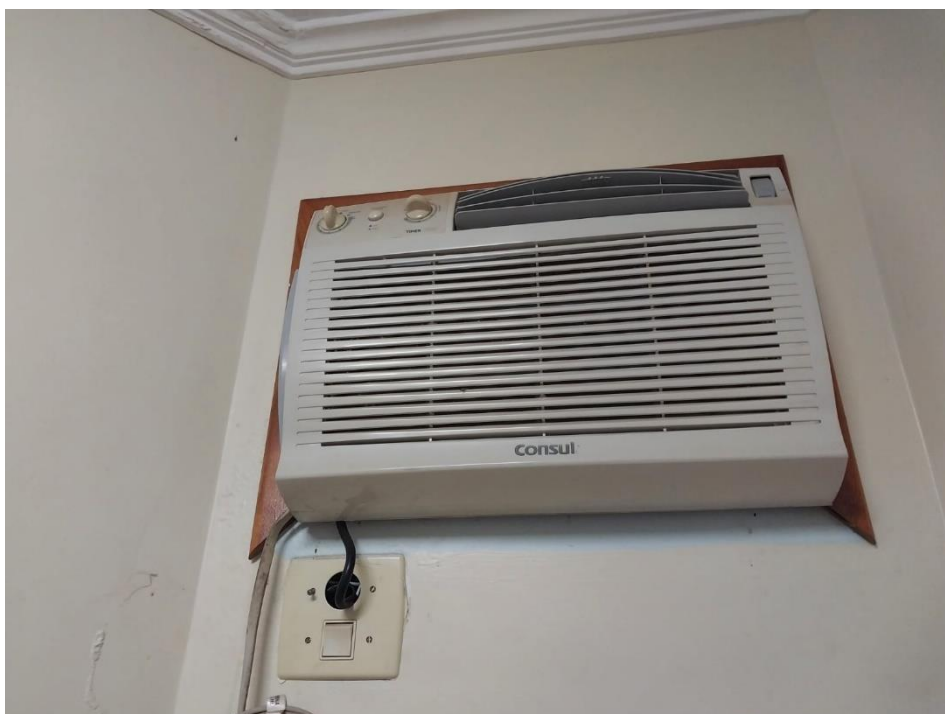
FOTO 1: Ar condicionado de janela 10.500 BTU.
