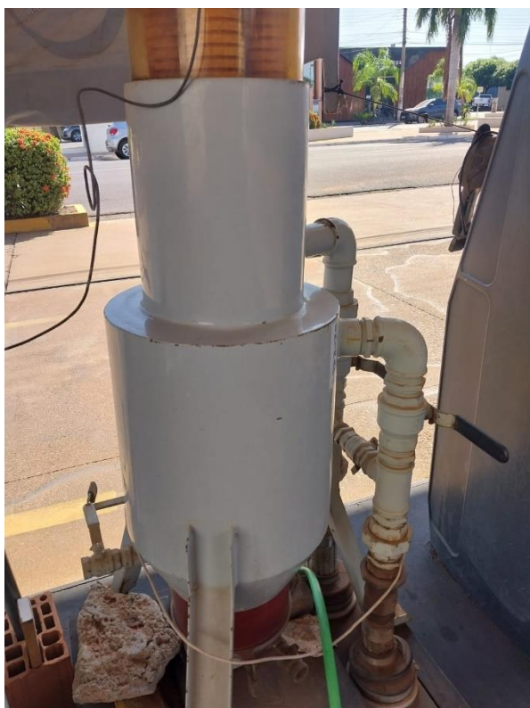
FOTO 58: Filtro desidratador diesel
