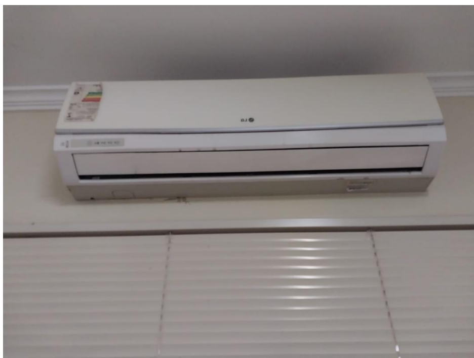
FOTO 2: Ar condicionado split 12.000 BTU LG com condensador.
