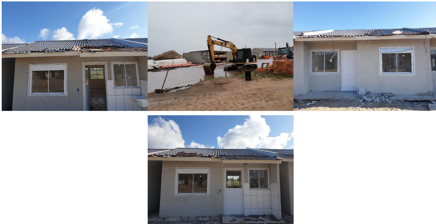
Figura 2 – Fotos sinistros ocorridos em 13/07/2013 no empreendimento SPE Vale Verde
