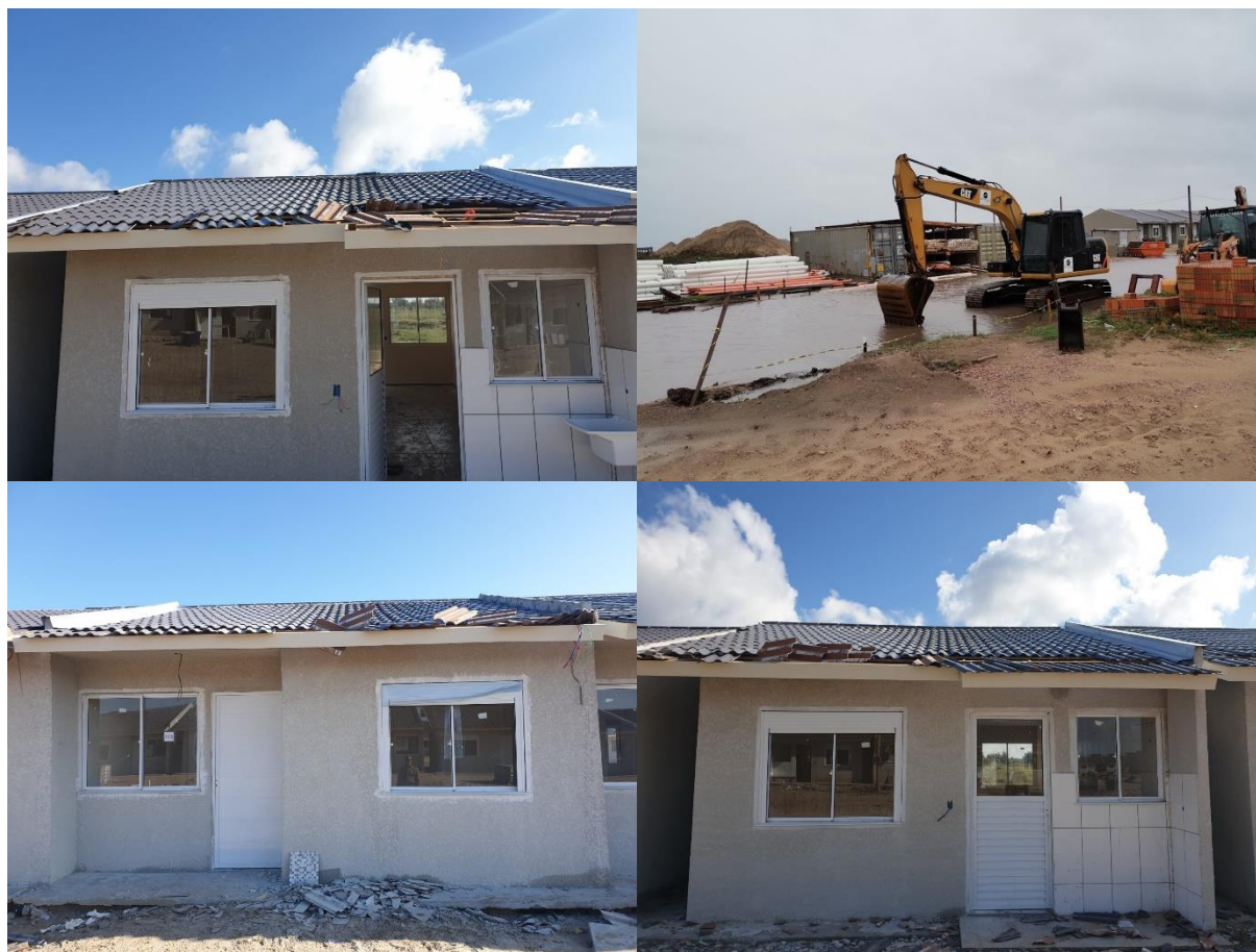
Figura 2 – Fotos sinistros ocorridos em 13/07/2013 no empreendimento SPE Vale Verde
